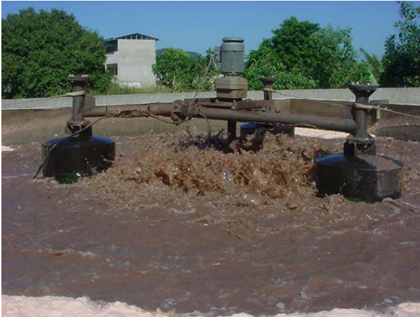
Aeradores lentos (fixos e flutuantes);
