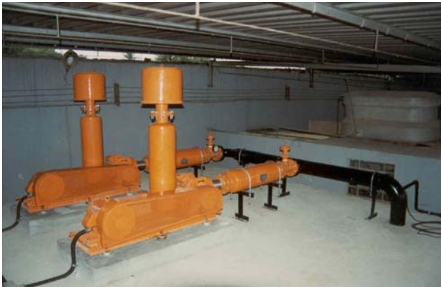
Sopradores de ar e malha difusora;
